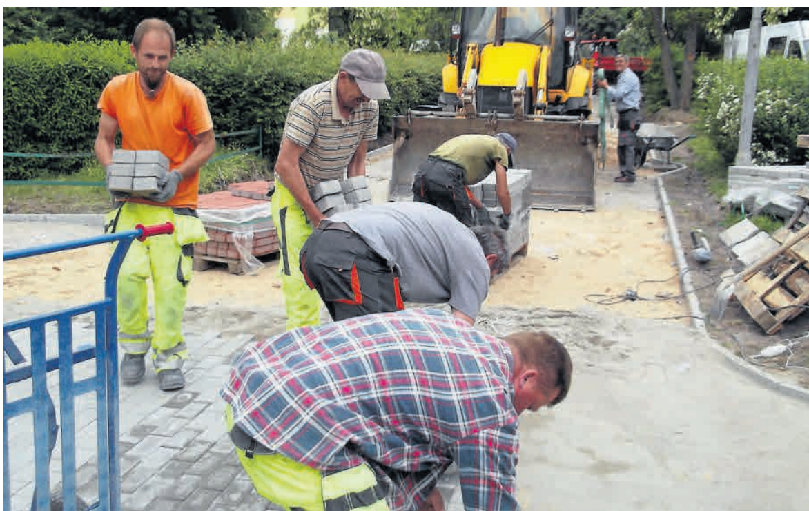
Trwają roboty drogowe między blokami PRZY UL. PISKORSKIEJ 5, 1, 13 i wieżowcami PRZY UL. DZIAŁOWSKIEGO 4, 6. Odbywa się tu REMONT CHODNIKA, który wykonuje Przedsiębiorstwo Wielobranżowe „Drobet” z Torunia
